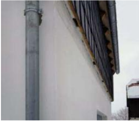
Abb. 21: Spaltenquartiere hinter Schieferverkleidung 4
